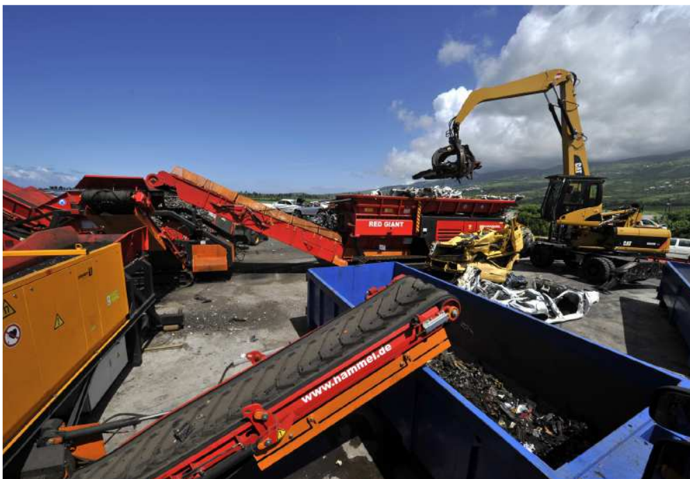
Installation de broyage de GENERALL AUTOS
